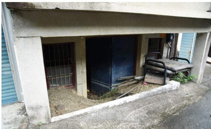
圖 2-14 義林西部野溪土石流扇地形單元上受土石流影響的家屋 (2022.07)
