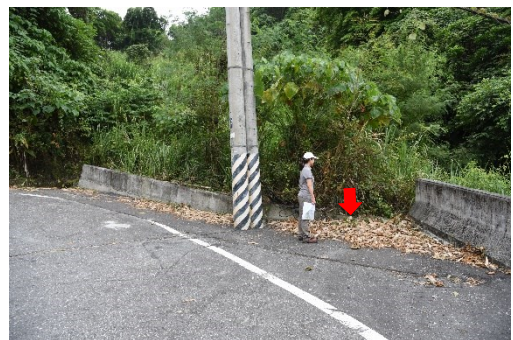
照片 3-7 點 9 道路護欄錯位下陷 (攝於 2020 年 9 月 9 日)
