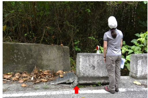
照片 3-5 點 8 水溝蓋似受力擠壓而局部隆起。照片左側為蝕溝位置 (攝於 2020 年 9 月 9 日)
