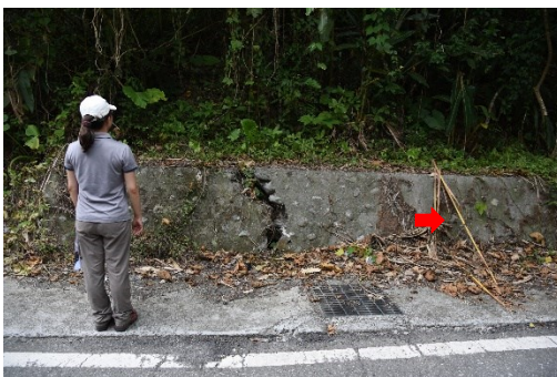
照片 3-6 點 9 擋土牆局部開裂 (攝於 2020 年 9 月 9 日)
