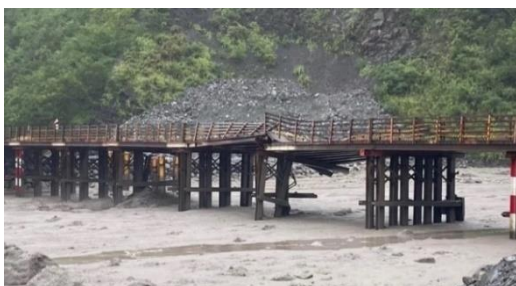
圖 5-5 2023 年卡努颱風豪雨引致玉穗溪土石流沖毀鋼便橋
