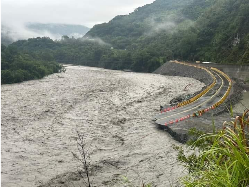
圖 3-21 台 20 線 100K 梅蘭明隧道河床便道因洪水損毀
