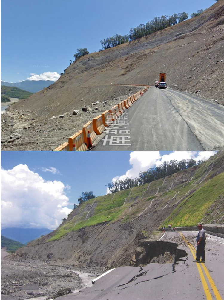
圖 4-7 荊山便道為 2009 年莫拉克颱風後之過渡性公路，於 2012 年 6 月之豪雨事件中受河流侵蝕坡腳而損毀
