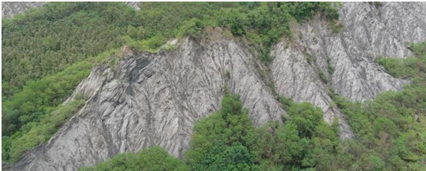
圖 3-10 颱風過境後所拍攝之惡地邊坡(攝於 2024/07/29)
